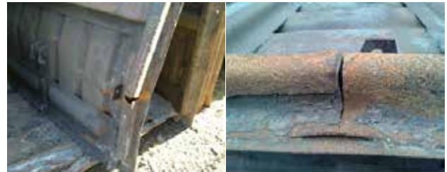
Рис. 1. Пошкодження бокового об'язування типової конструкції кришки люка
